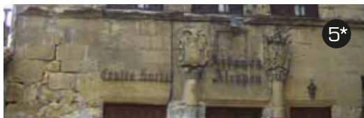
Edificio del siglo XVI de sillaría y entramado de ladrillo con alero de madera tallada.
